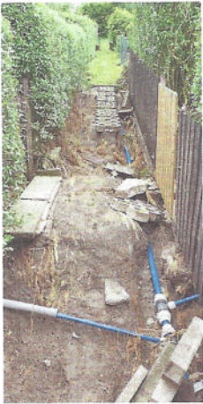
Die Flutwelle hatte den Gartenweg schwer beschädigt.
